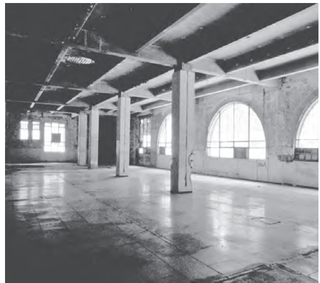
Vistas del estado original del edificio durante el proceso de intervención. Fotografías: SA y Gerardo Gómez (GG), 2004
