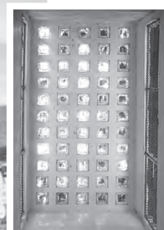
Sistema de iluminación para aulas en la misma EBA. Fotografía: FLV, 2015
